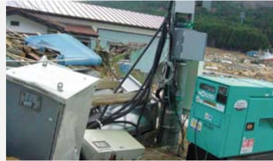
発電機を設置した基地局
