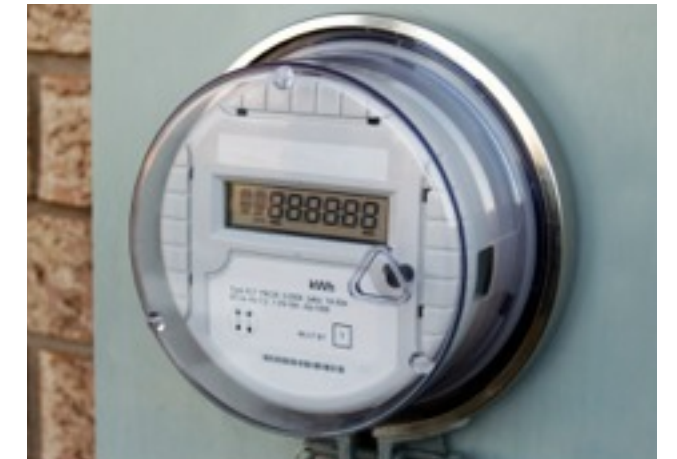
スマートメーター
